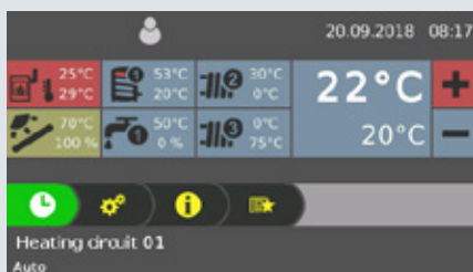
Afb. 1 Algemeen overzicht van het verwarmingscircuit (startscherm)
